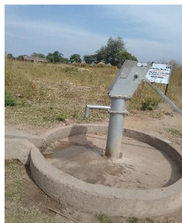
La pompe de Boromada installée
